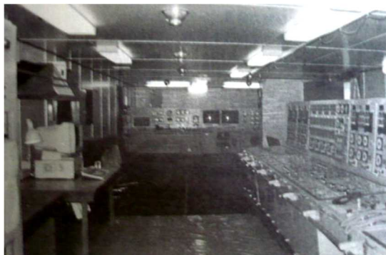
16) W65-16 同左 集中制御室
