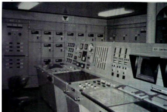
14) W65-14 同左 冷凍装置制御盤
