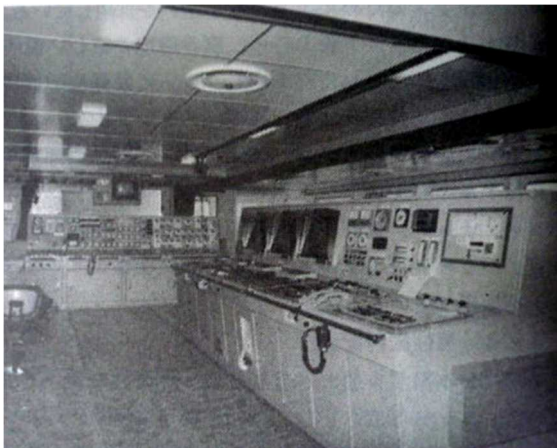
4) W65-04 筑波山丸 中央制御室
