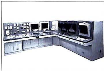
エンジンコントロールコンソール
