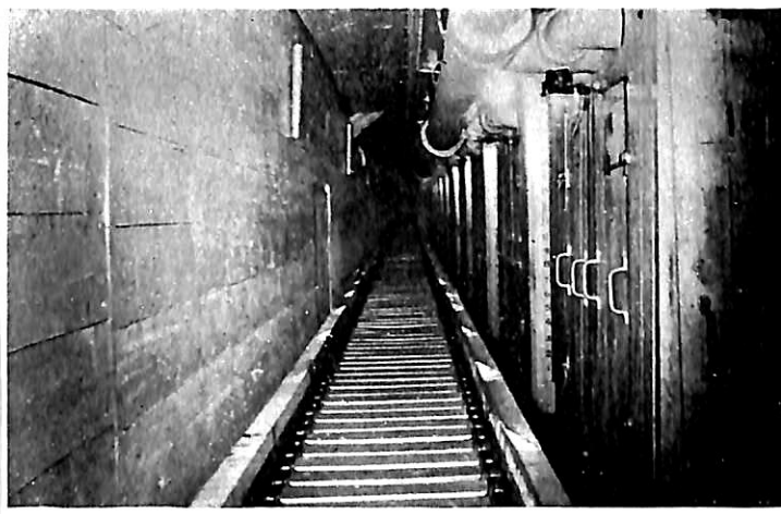
急速冷凍室 (中央はエプロンコンベヤー)
