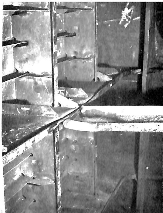
写真 10 水圧試験破壊状況 (Horizontal Stringer System Tank)
