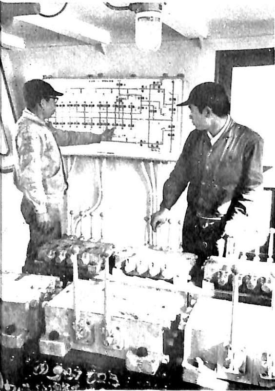
写真 2 ホッパー操縦室
