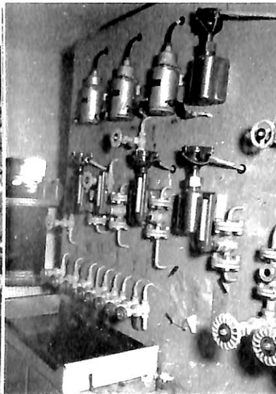
制御室内給水装置 サンプリングラック
