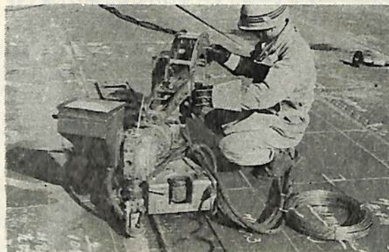
1—16図 心線接続の作業状況(1) ワイヤ・リールのふたをとるところ
