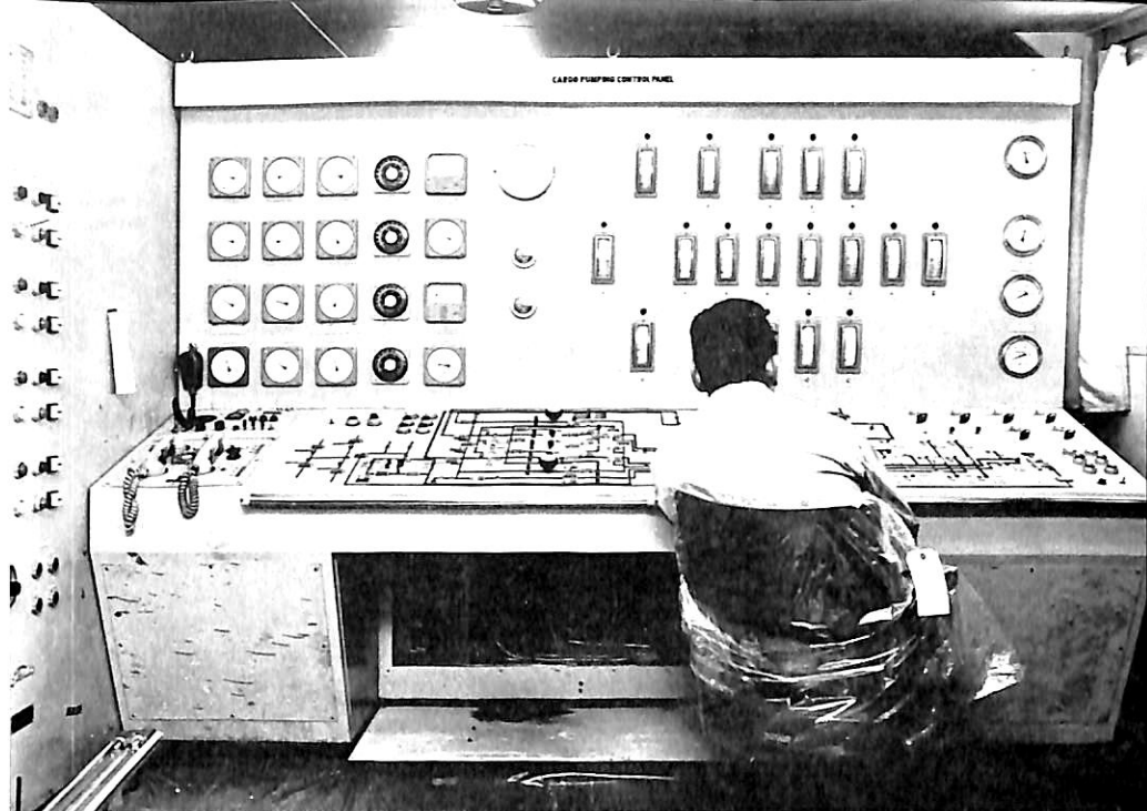
荷役集中制御室
