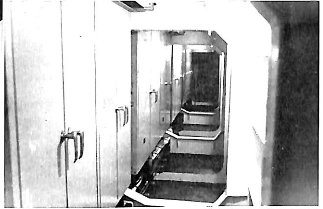
写真 5 主桁内に設置され た制御盤類
