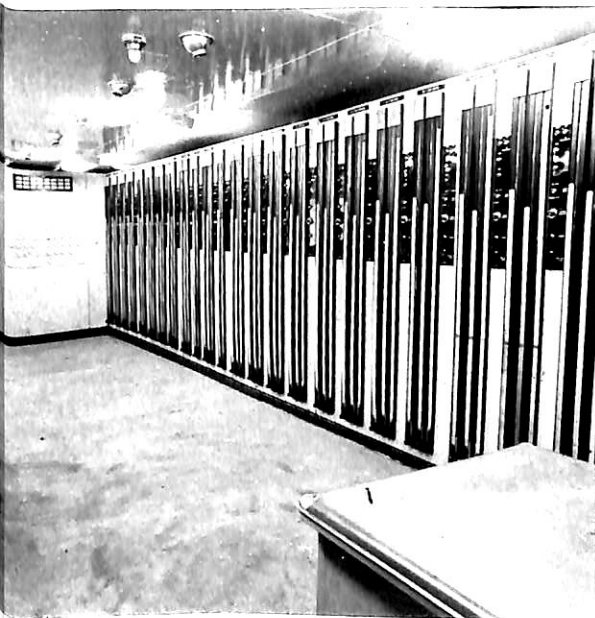
荷役制御室（液面計および吃水計）
