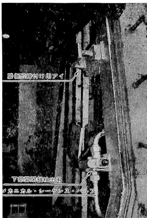
写真 8・40 下部扉閉鎖検出用メカニカル・シーケンス・バルブ
