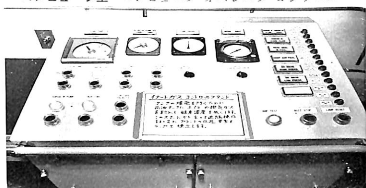
荷役制御室 イナートガス コントロール スタンド
