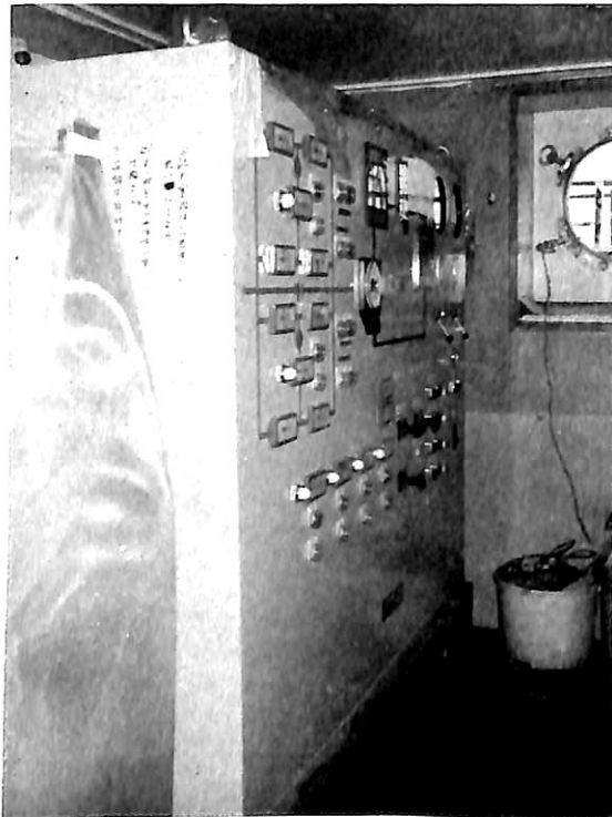
新設カーゴコントロールルーム内コントロールパネル
