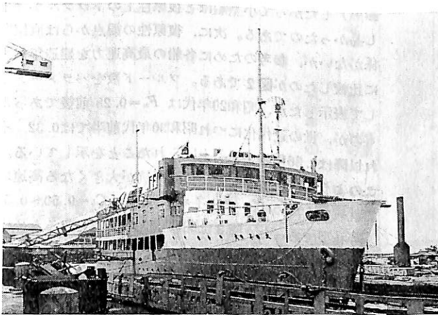
写真3 復原性改善のため操舵室位置下げ工事中の 太平丸（旧操舵室は一段上方に設けられて いた）
