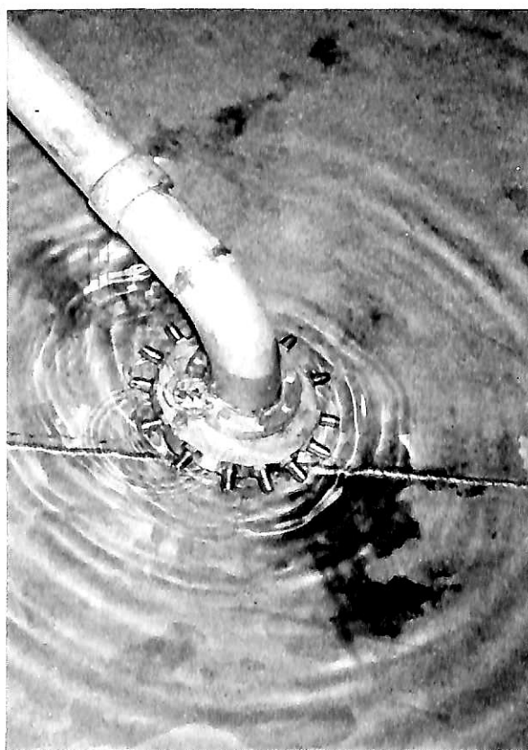
燐酸用循環かくはん装置のタンク内に設けられた ディフューザーノズル
