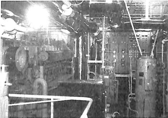
主配電盤、主機及び油水分離器（排気管系統の パイプカバー仕上げはオールステンレス）
