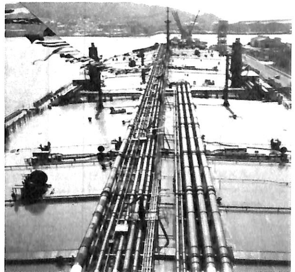
写真1 上甲板上的配管状況
