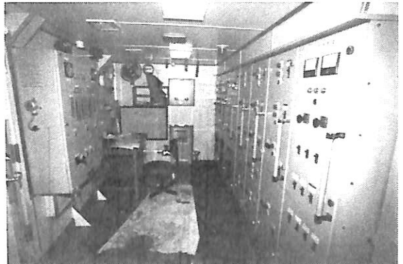
エンジン コントロール・ルーム
