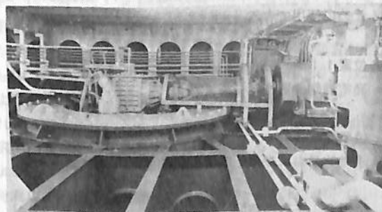
▲4基の Schottel 全方向スラストの1基：接近は上方の車両甲板内の取り外し可能なパネルを介して行う
