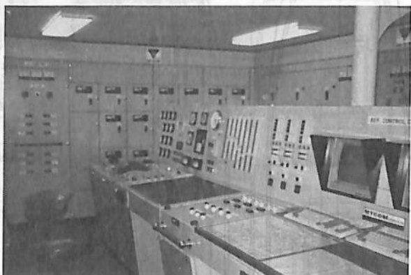
▲冷凍装置制御盤
