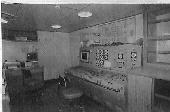
▲ カーゴコントロール室
