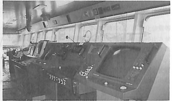
▲ 操舵室と制御・監視システム
