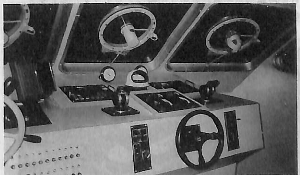
▲ 写真 2 操縦装置
