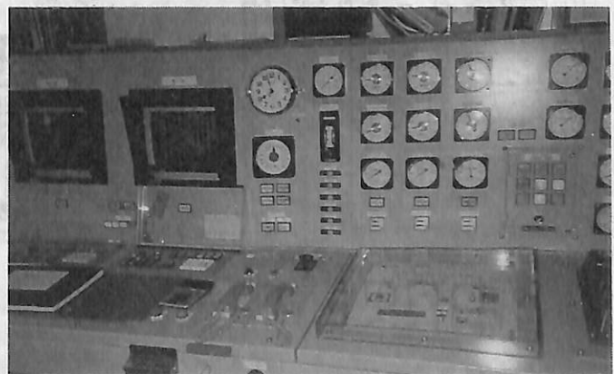
▲写真-5 機関監視盤
