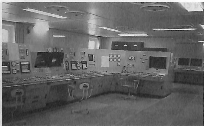
▲ 貨物制御室 (操舵室直下の居住区内に設けられている)
