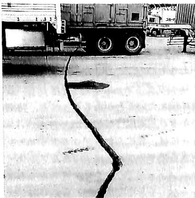
▲岸壁に見る釧路地震の際のヒビ割れ拡大、地震の大きさがわかる。
