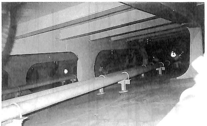
▲ ホールドボトムのエアレーション用パイプ
