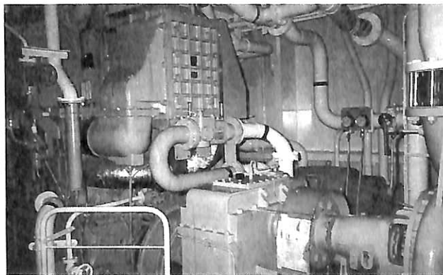
▲ 主機関(左)と消防ポンプ(右)
