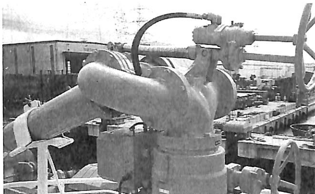
▲ 250 A水モニター
