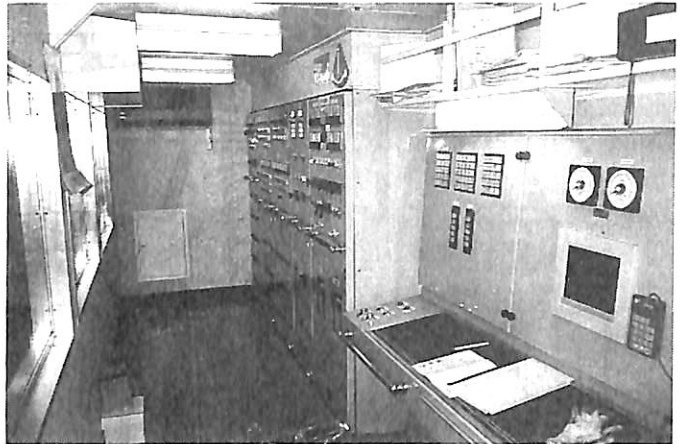
▲ 機関制御室(プッシャー)
