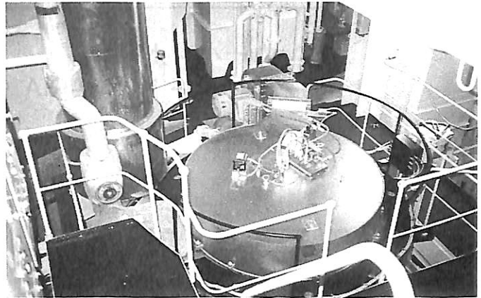
▲ 熱媒油式ボイラ
