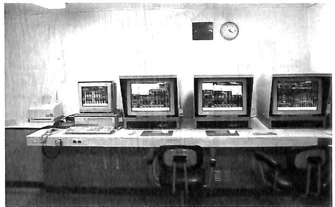
▲ 遠隔荷役監視制御装置
