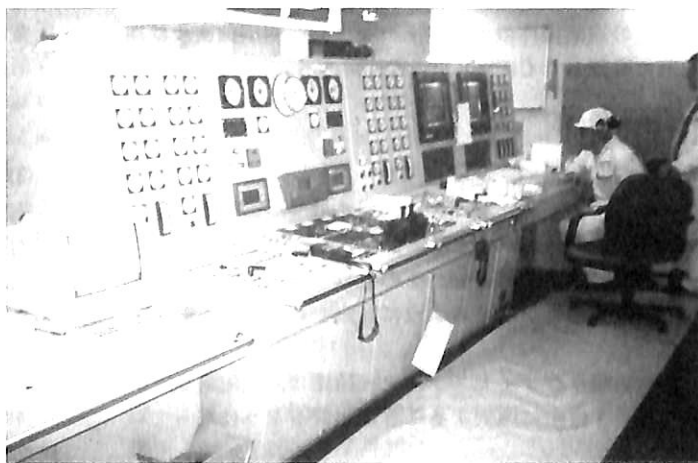
▲ エンジンコントロールルーム
