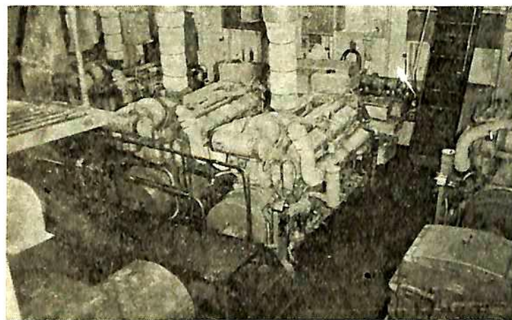
機械室内主機および減速機
