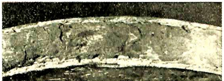
第25図 管内面のスケールの状況(破裂したものの隣りの管)
