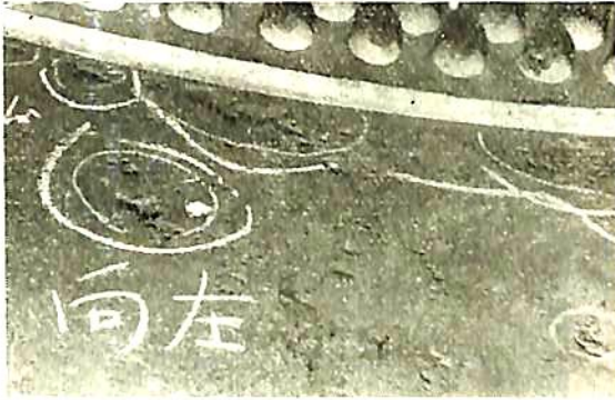
第3図 胴板下部水側の腐蝕の一例
