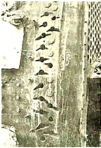
第16図 鋼板のアルカリ脆化による鉄孔の亀裂（ガウジングによつて亀裂を除去した後の状態）
