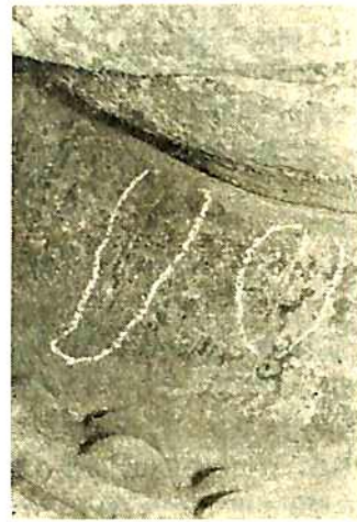
第5図 前鏡板の火炉取り付け彎曲部水側に発生した亀裂
