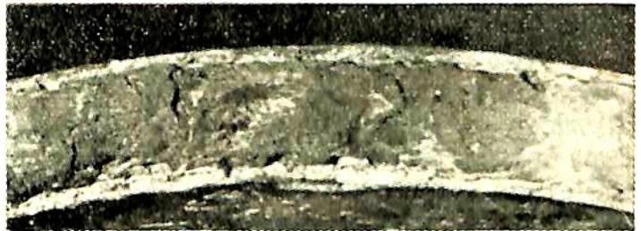
第25図 管内面のスケールの状況 (破裂したものの隣りの管)
