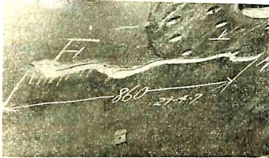
第2図 2号型の銅板人孔附近に発見されたラミネーションによる開口(使用後8年9ヶ月)
