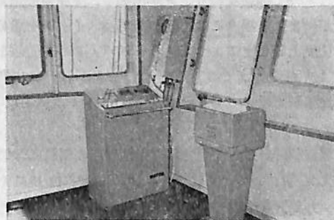
写真—11 浚渫操作盤およびドラグアームウインチ制御器 (右舷)
