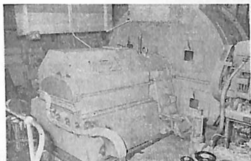
写真—8 推進電動機本体および附属機械 (左舷機)
