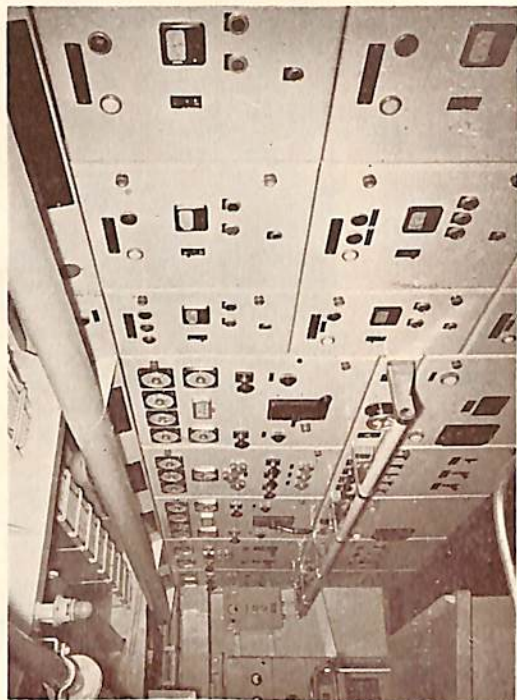
機関室内の主配電盤
