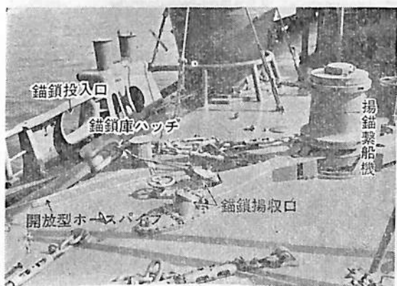
後部4点係留錨装置
