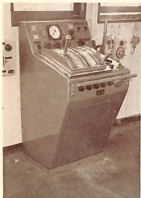
主機遠隔操縦台
