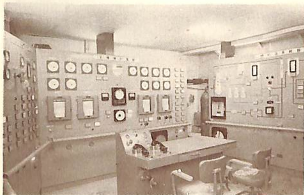
監視室 (機関室内)
