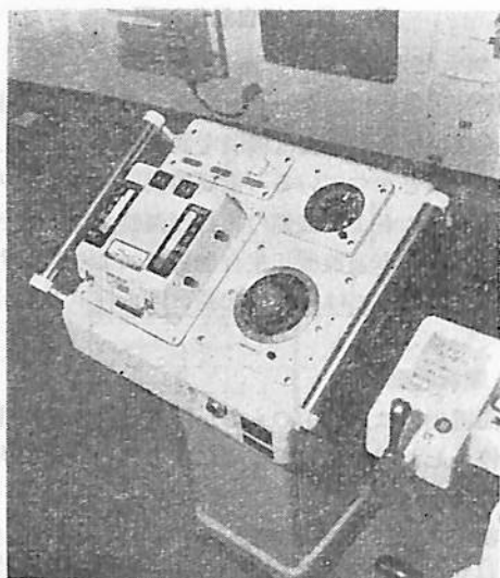
船橋操舵室主機操縦台
