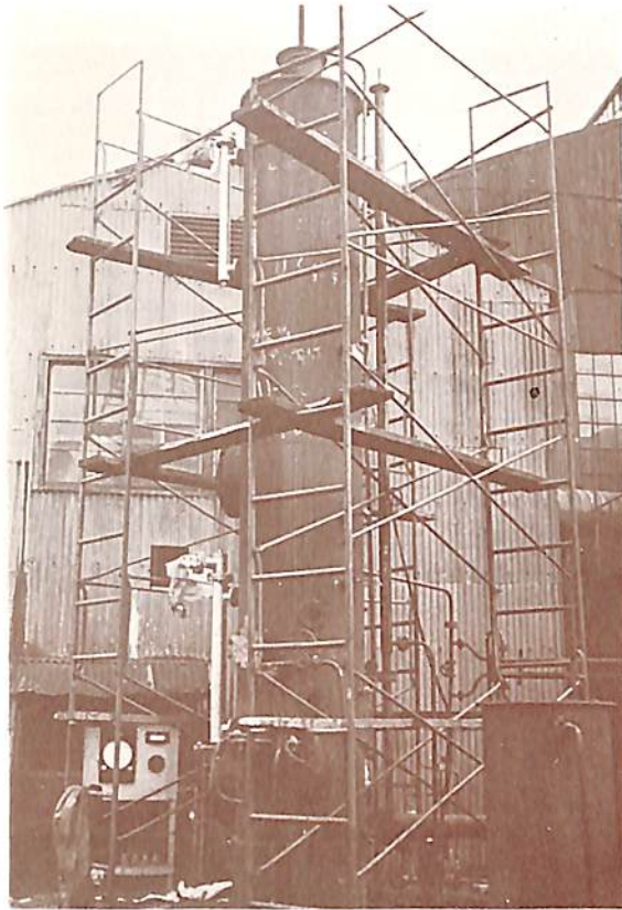
テストに使用された T-NK 式原油燃焼用水洗塔
