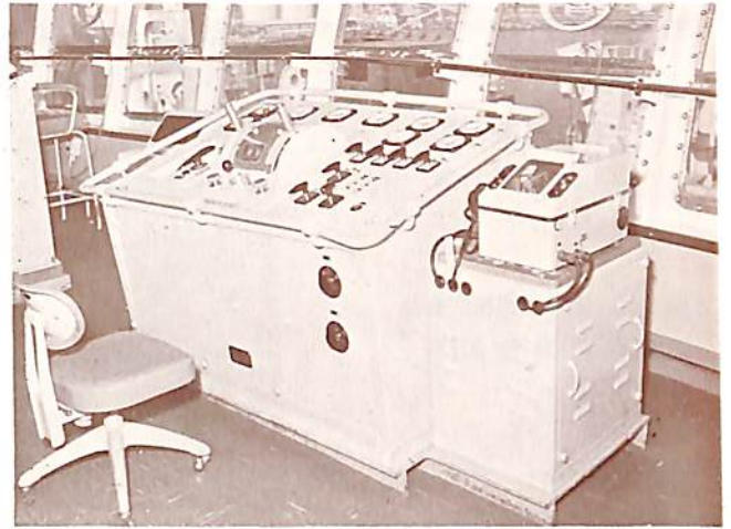
主機船橋操縦盤
