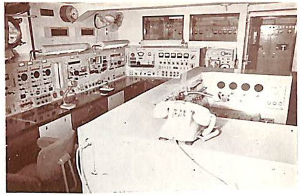
通信室，監視操縦盤より左舷側（仕切壁のむこうは送信機室）
