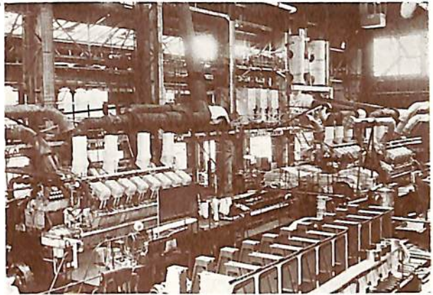
3台(1軸)結合運転中
