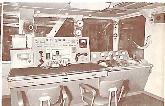
機関制御室，主機操縦盤（ログテーブル）
