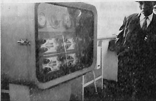
第 3 図 ウイングにあるサイドスラスター制御盤
