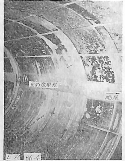
図 41 E丸の支面材損傷写真
