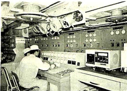
第7図 制御配電盤（前方）と操縦室 制御盤（手前）
