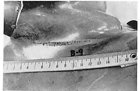
キャビテーション・エロージョンを起して、 200時間後に水泡により空洞現象を生じた写真
