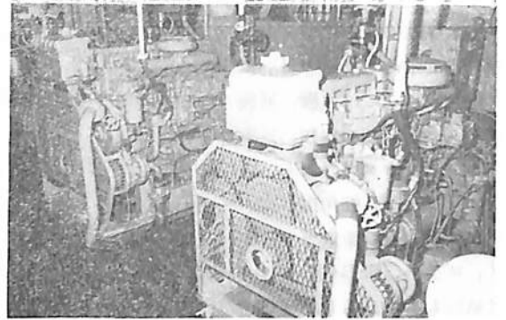
写真-12 機関室(補機)
