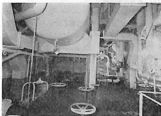
写真 1: ポンプ・ルーム内に装備したコアレッサー
