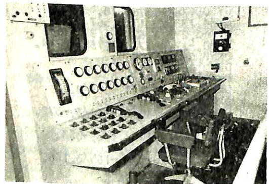
第 7 図 コントロールコンソール (機関室)
