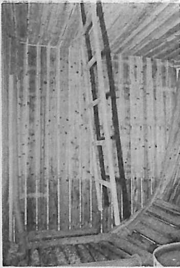
ブライン凍結魚倉 ブライン循環パイプが見える。床 面パイプに見える孔はブライン吐 出口である。
