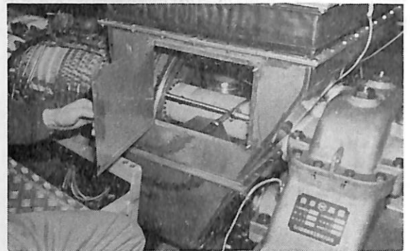
写真5 吸気管手入孔と減速装置
