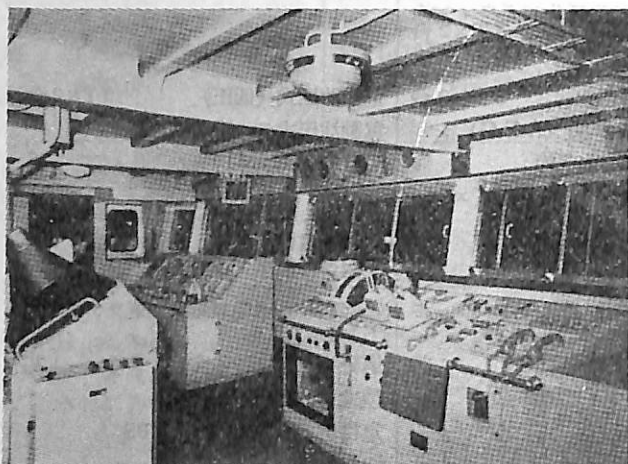
航海船橋 主操船盤 (右) 右→左 (電話+マイク)→サイドスラストステレグラフ→主機テレグラフ→主機関係メータおよび警報器 副操船盤 (左) 右→左 錨鎖計→テレビ→停止惰力計
