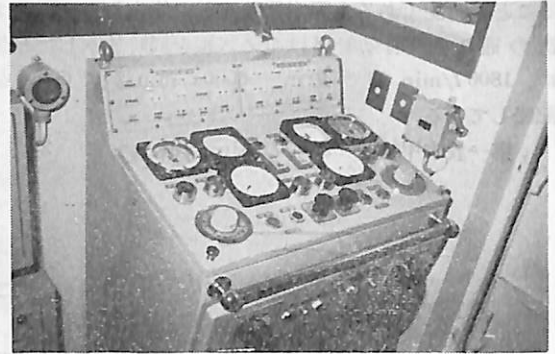
図5 主機遠隔操縦装置用スタンド
